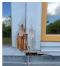
Der Fensterrahmen ist im Bereich des Wetterschenkels durch Wasser völlig zerstört.
