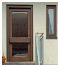
Haustür und Fenster aus Holz sind in die Jahre gekommen und entsprechen auch nicht mehr dem Geschmack der Zeit.
